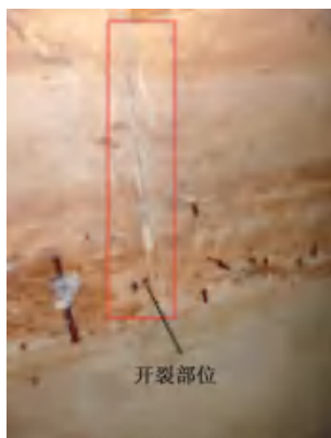
图 11 内衬层树脂材料表面出现高温老化情况
